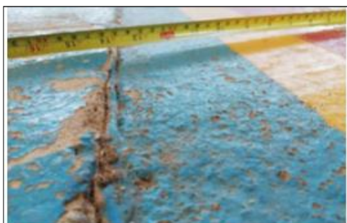
Se presenta hundimientos y diferencias de nivel entre las placas de la cancha
