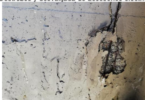
Delaminación del concreto, corrosión del acero y filtraciones por humedades en la viga canal del costado occidental del coliseo
