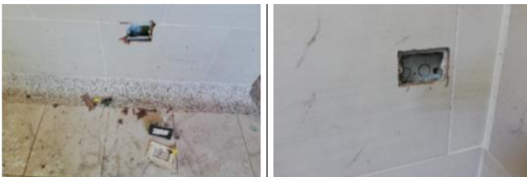
Destrozos y desvalijada de accesorios eléctricos – tomas, alambres, cables, interruptores, etc.
