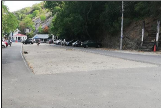
Carpeta asfáltica en la zona del malecón, las cantidades no corressponden a las recibidas
