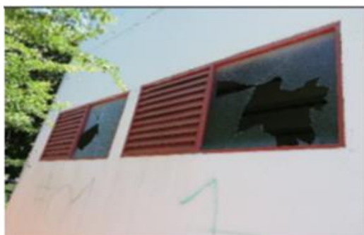
Vidrios destrozados en la fachada sur
