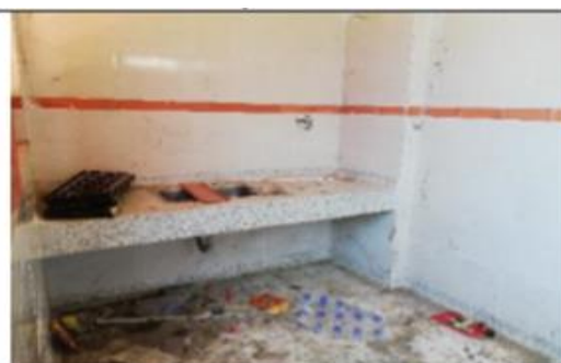
Daños en el interior de los módulos
