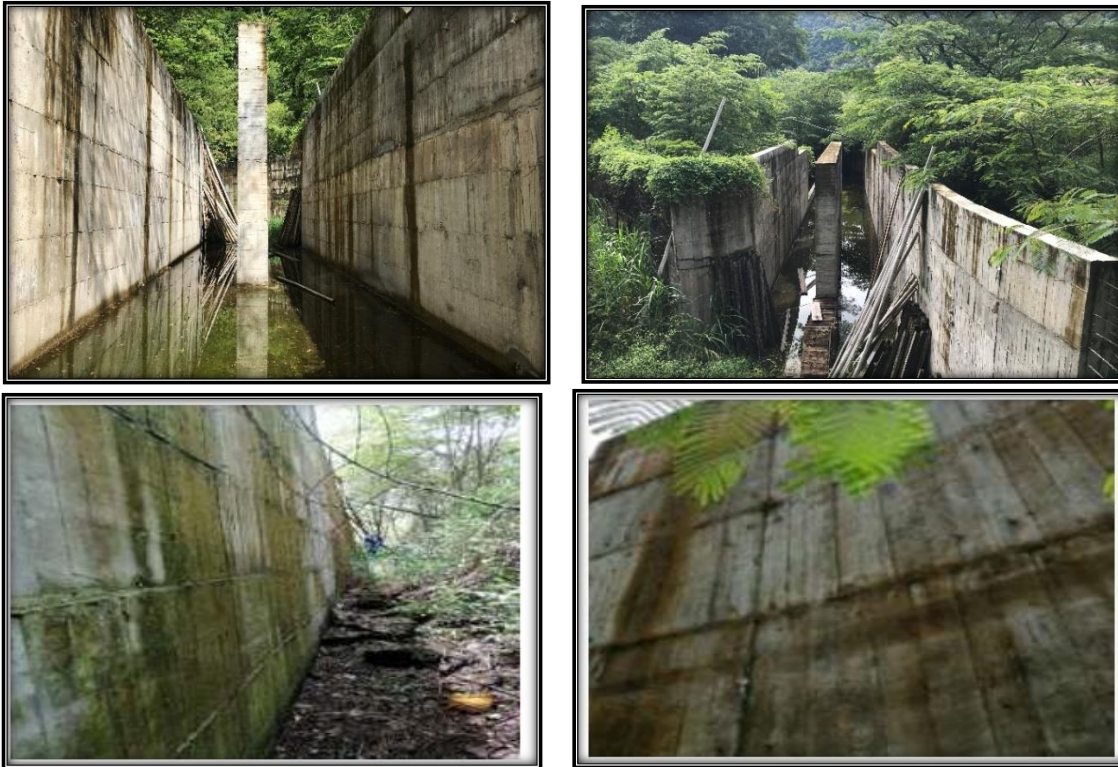
Fuente/ Tomado informe Técnico- Ingeniero CGR -visita agosto 2020
